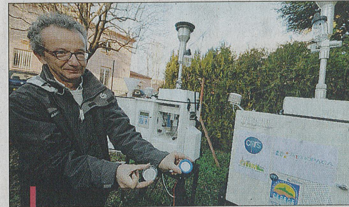
Cinq stations de mesure ont été installées sur le bassin minier de Gardanne.
